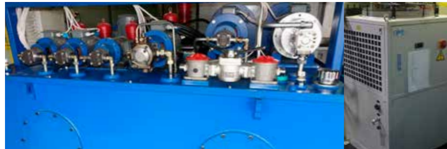
Gut temperiert: Die Hydraulikeinheit besteht aus Bosch Rexroth-Komponenten, die das Öl mehrstufig filtert. Ein Sensor überwacht die Fluidtemperatur, die der Ölkühler in einem festgelegten Bereich hält.
